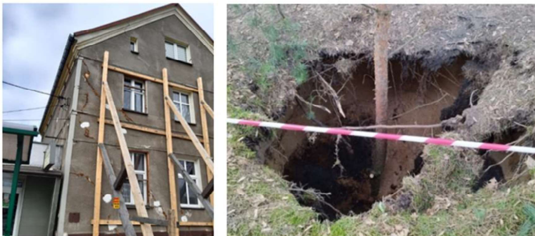
Rys. 1a Przykład uszkodzeń budynku, 1b Przykład zapadliska na terenie pogórnym
